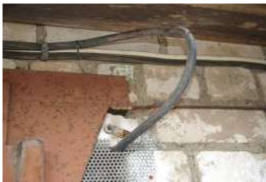
Būve ar kadastra apzīmējumu 1700 002 0135 004, garāža Nr.367, elektropieslēgums
